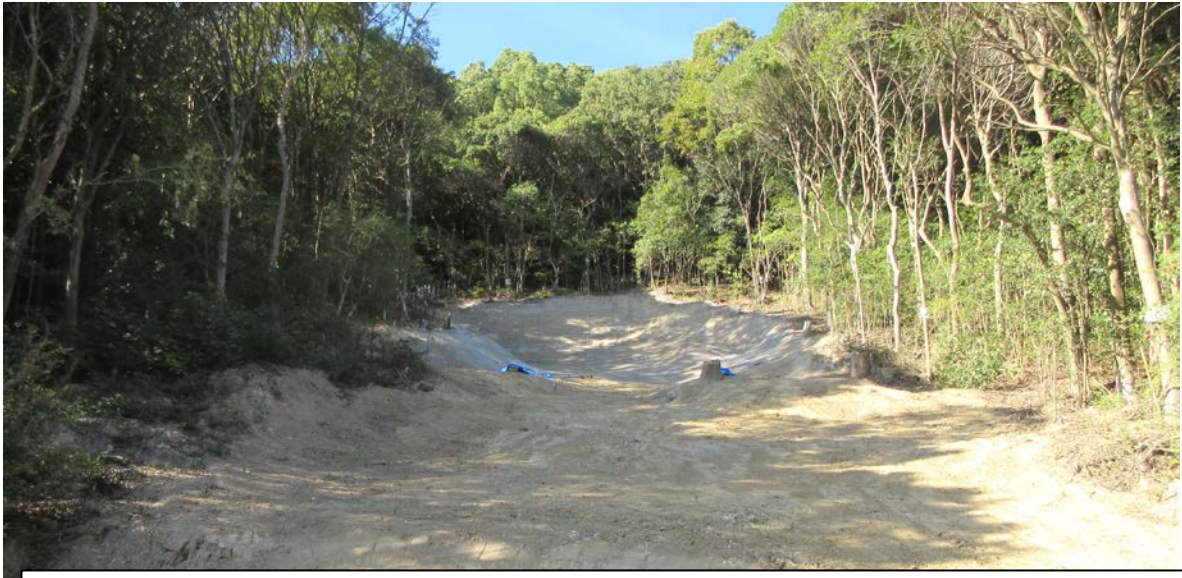
半田山の崩壊箇所 基盤岩が泥質ホルンフェルスでD級風化部分にバーミキュライトを多く含有していた。
