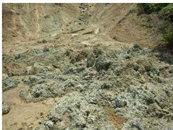
写真-2 崩壊土砂(汚泥)
