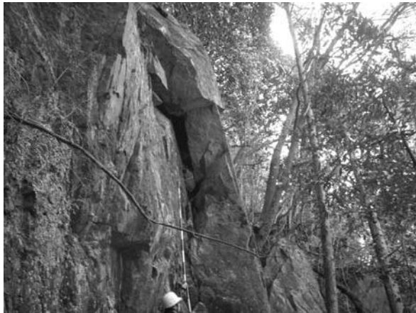
写真 11 落石源となりうる急崖斜面
