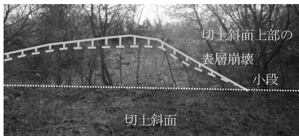
写真 9 切土斜面の表層崩壊
