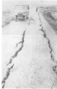
亀裂の入った道路 (岡山市三幡付近)
